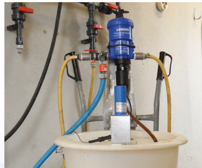
Pumpentechnik inkl. Additivbehälter für die Dosierung von Additiven (z.B. Ergänzungsfuttermittel, Arzneimittel) und Trinkwasserdesinfektionsmitteln
