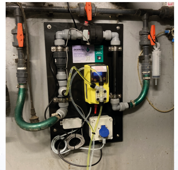
Einsatz von Chlordioxid über eine Dosiereinrichtung
